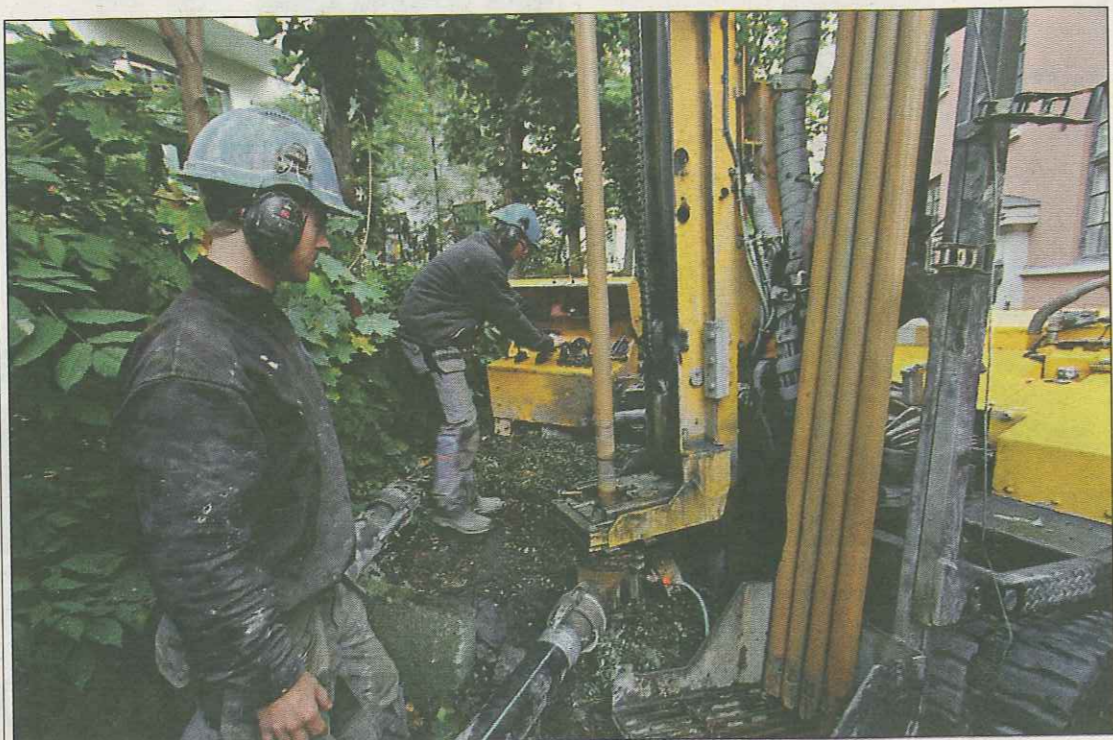
Flere bør gjøre som dette sameiet i Hjørungavågata på Frogner, mener Oslo kommune. De borer 200 meter ned i grunnen for å få varme fra bakken. FOTO: HEIDI JOHNSEN
